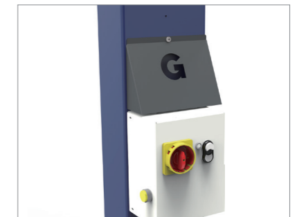
CONTROL PANEL QUADRO ELETTRICO
